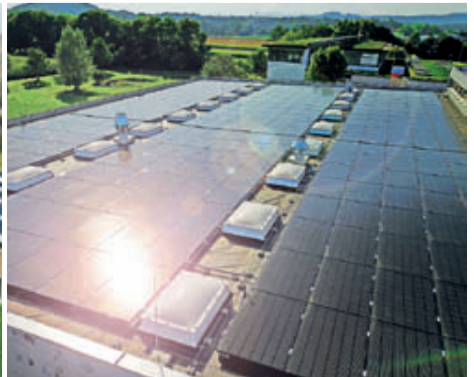
Eine eigene, 148-kwp-starke Photovoltaik-Anlage produziert mehr Strom als für den täglichen Gebäudebetrieb gebraucht wird. ✕ @ . gugler
